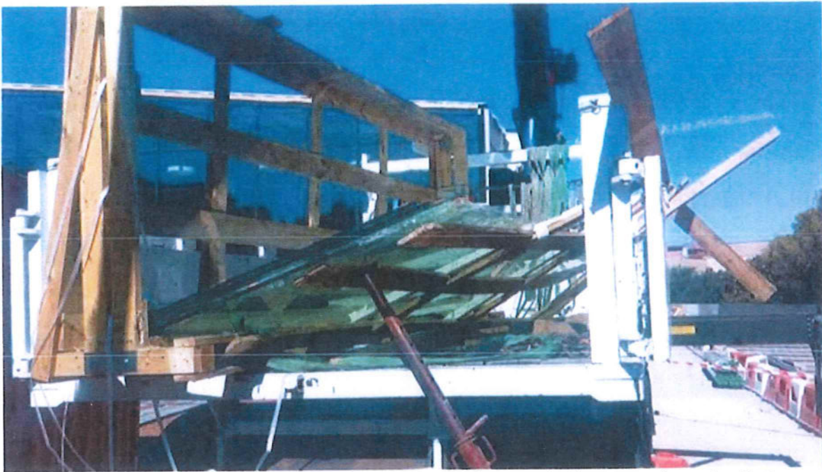
Photo 4 : Vis arrachées sur la planche supérieure et étai pour soulager la victime
